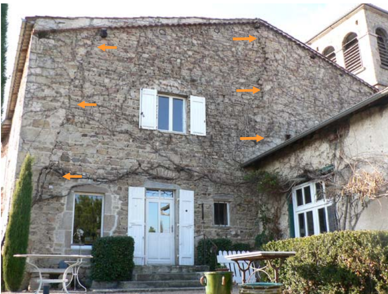
Photo 9 : façade est, traces de modifications
