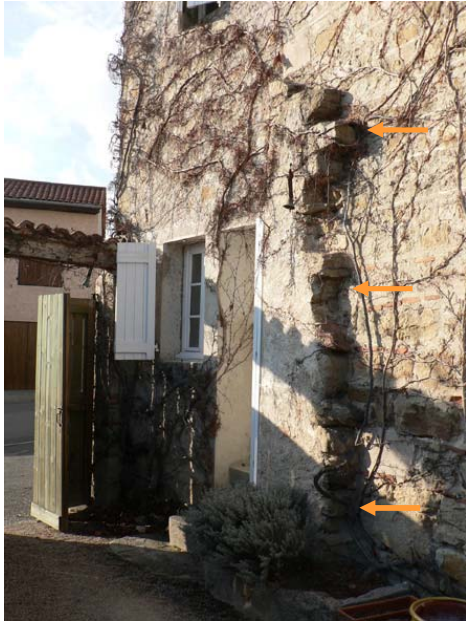
Photo 7 : façade sud : arrachement
